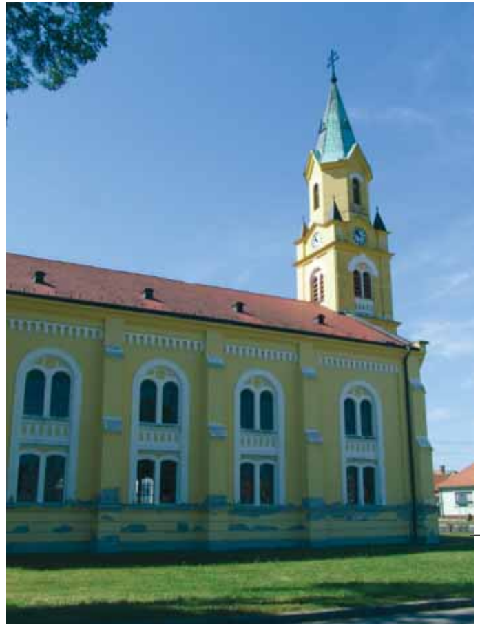
A TEMPLOM ÉSZAKI OLDALÁN JÓL LÁTHATÓ A MÁLLÓ VAKOLAT
